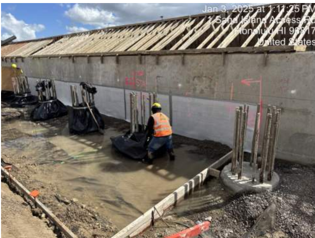
KIWC installing plastic bond breakers for the mud mat pour on Pier 43
